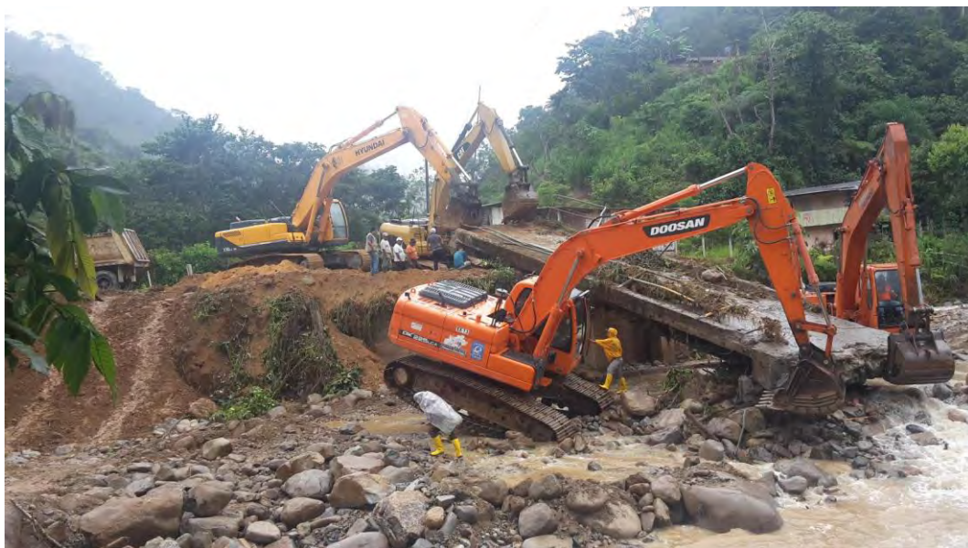
Ilustración 9. Puente colapsado en San Carlos de las Minas, paso a Campanas
