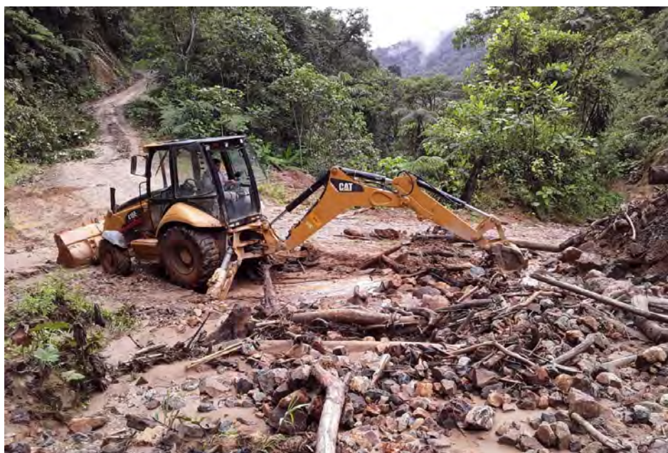
Ilustración 10. Alcantarillas colapsadas por el arrastre de material, rocas y madera
